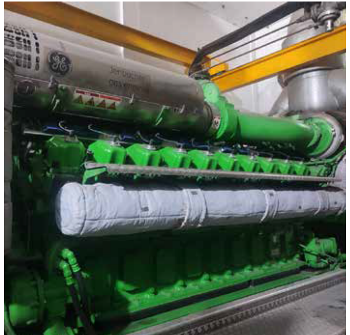
เครื่องยนต์แก๊ส INNIO Jenbacher JMS 620 Type J ที่ Suraj Cotton Mills Ltd, Raiwind, Punjab
